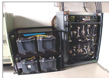
▲ На случай отключения энергии на базовых станциях установлены блоки бесперебойного питания
