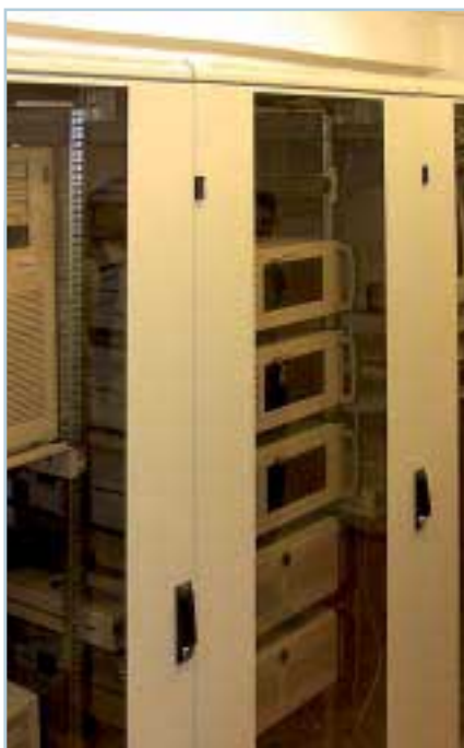
Serverovna strahovské počítačové sítě
